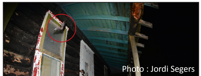
Figure 12. Pour que l'exclusion réussisse, il est important de sceller tous les autres jours et espaces par lesquels les chauves-souris pourraient accéder au bâtiment.
